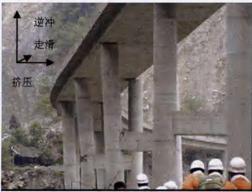
照片 3 梁柱效应 Photo 3 Beam-column effect
