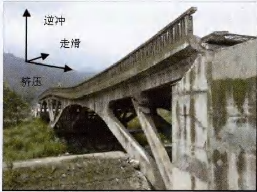
照片 7 小鱼洞大桥垮塌 Photo 7 Collapse of Xiaoyudong bridge
