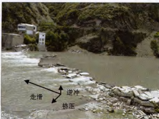
照片 11 南坝明月渡大桥垮塌 Photo 11 Collapse of old Nanba bridge
