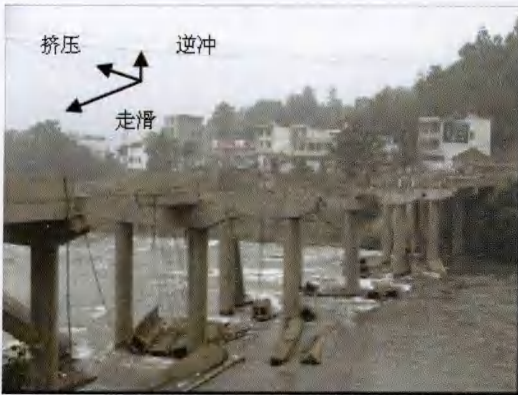
照片 9 南坝镇新桥落梁（上游侧） Photo 9 Collapse of new Nanba bridge (up stream)
