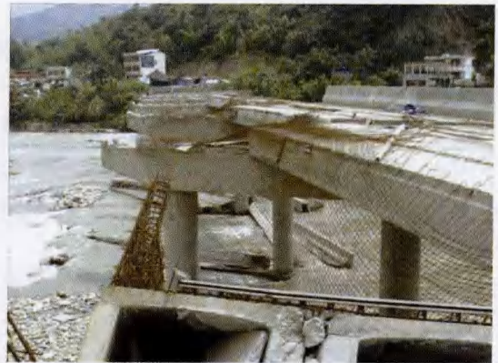
照片 10 南坝镇新桥落梁（下游侧） Photo 10 Collapse of new Nanba bridge (down stream)
