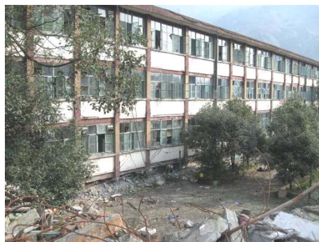
(d) 映秀镇某宿舍底层倒塌
