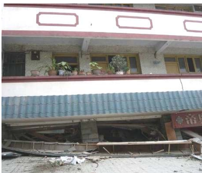
(c) 某底框住宅底层倒塌，2层花盆仍在原位
