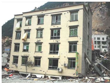
(b) 北川某底框住宅底层倒塌
