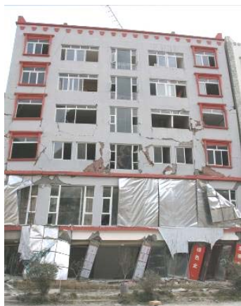
(a) 北川某底框住宅底层严重倾斜破坏
