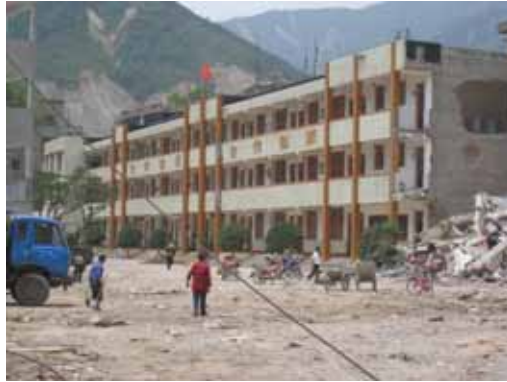
(b) 整体 (建筑右边部分倒塌)
