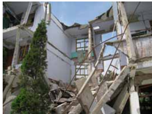
图 9 楼梯间倒塌 (No.3 楼)
