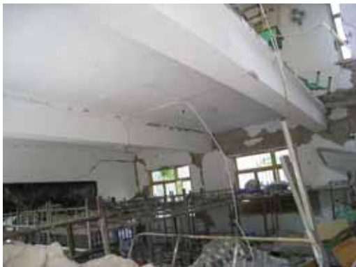
图 8 纵横墙连接处破坏 (No.3 楼)
