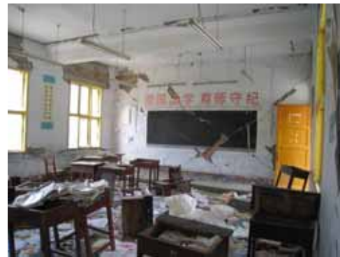
图 7 墙体交叉裂缝(No.1 楼)
