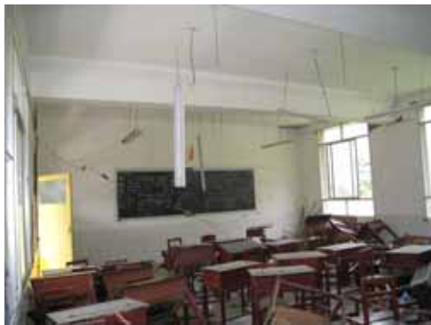
图 6 墙体斜裂缝和水平裂缝(No.4 楼)
