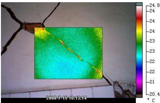
图 7 砖混结构承重墙 X 剪切裂缝红外图像
