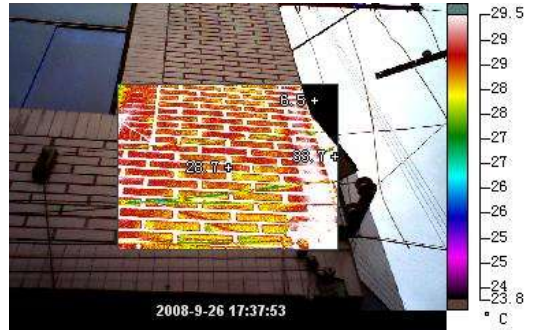
图 10 砖混结构承重墙破坏红外图像
