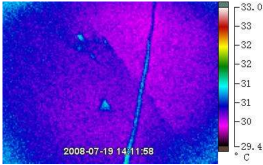
图 9 砖混结构承重墙破坏红外图像
