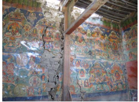
图 6 梁下端墙体开裂
