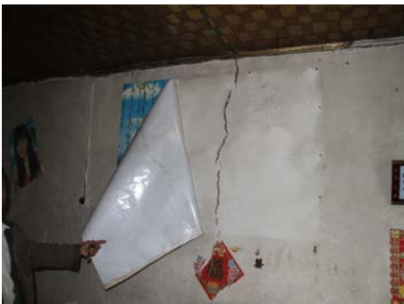
照片 7 大庄子 土木房屋墙体竖向开裂
