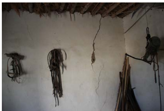
照片 1 查干莫敦村土坯房纵墙竖向开裂
