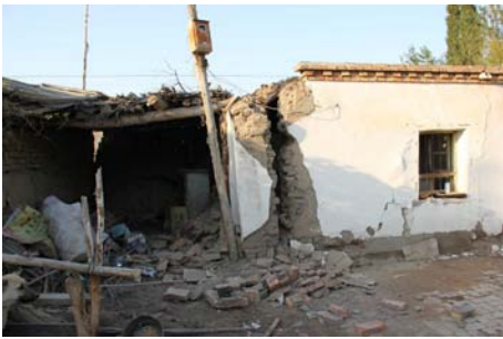
照片 5 依克呼都格村土坯房山墙局部倒塌
