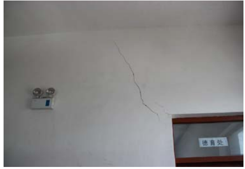
照片 4 托里中学砖混结构教室填充墙开裂
