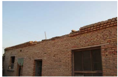
照片 6 吾夏克巴依村砖木结构房屋檐口塌落
