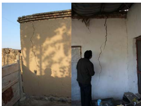
照片 2 乌兰旦达盖村土木房屋墙体开裂
