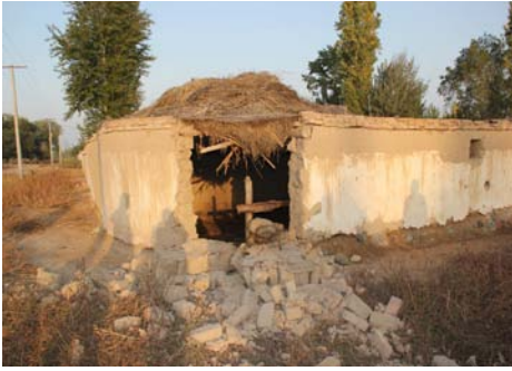
照片 3 乌兰旦达盖村个别居民院墙倒塌
