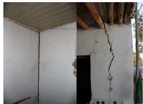
照片 8 八家户牛场农牧一队土木房屋墙体严重开裂
