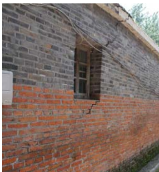
(a) 实心砖窗间墙墙体开裂
