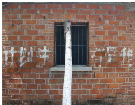
(b) 空斗砖窗间墙墙体开裂
