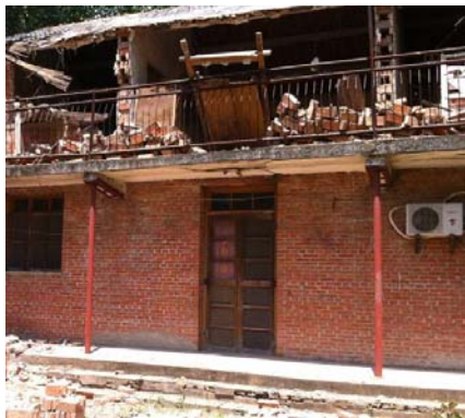
(a) 上部墙体倒塌下部完好
