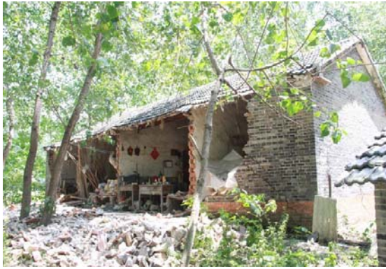
(a) 河道附近民居墙体局部倒塌
