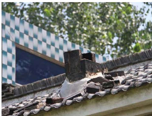
(b) 烟囱顶部塌落
