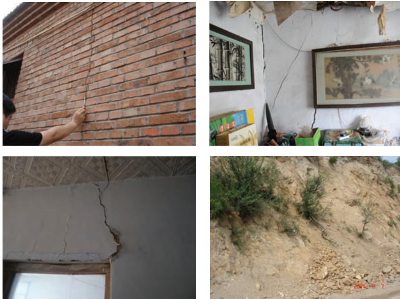
图4 涿鹿 M_S4.3 级地震典型震害图 (墙体裂缝及小规模边坡滑塌)
