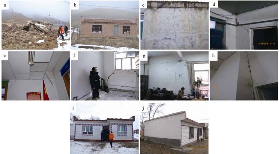
(a) 雀儿沟村三片区土木结构房屋整体倒塌; (b) 雀儿沟村三片区砖包土房屋墙体砖块脱落; (c) 塔西河乡红沙湾村砖木竖向轻微裂缝; (d) 雀儿沟砖木房屋门角裂缝; (e) 小甘沟煤矿办公楼圈梁裂缝; (f) 雀儿沟镇白杨沟煤炭公司水房砖混墙体开裂; (g) 神华天电矿业框架结构剪切裂缝; (h) 玛纳斯县土驿镇框架结构裂缝; (i) 雀儿沟镇西沟村安居房完好; (j) 雀儿沟镇霍斯铁列克村安居房完好
