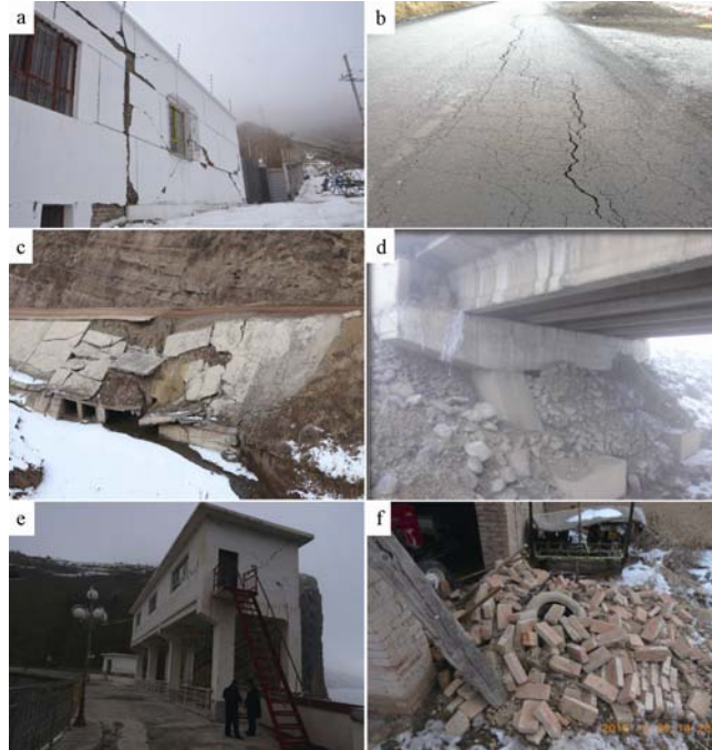
(a) 西沟变电站山墙贯穿剪切裂缝; (b) X146 线路面纵向贯通缝; (c) S101 省道过水涵洞垮塌; (d) 红山大桥肋板台基础外露; (e) 塔西河石门子水库闸井室贯穿剪切裂缝; (f) 玛纳斯县包家店镇柴场村砖木羊圈坍塌
