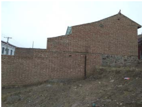
图 3 调研区未经抗震设防砖混房屋的典型照片
