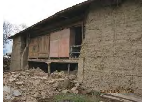
图4 土木结构毁坏
